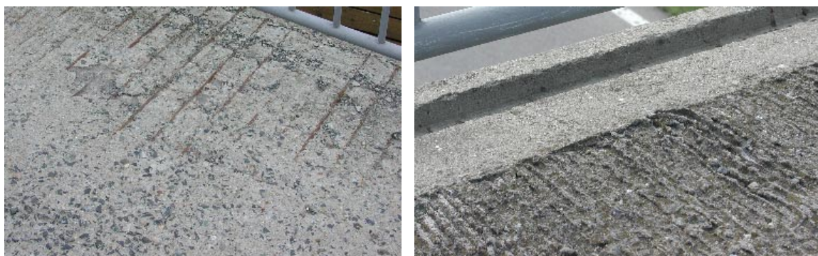
Obr. 2 – Vlevo porušená mostovka na lávce v km 21,5, vpravo neporušená mostovka na lávce v km 27,0
