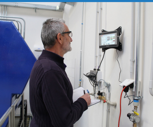
Displej ovládání a měření úrovně hladin pomocí SW
